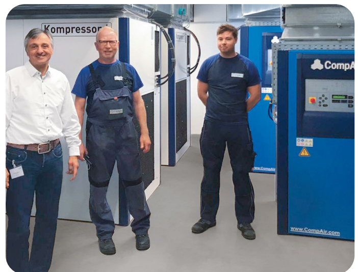
Josef Friedl, Geschäftsführer der A&F Druckluft GmbH (links), projektierte eine Ergänzung der Druckluftstation um einen weiteren drehzahlgeregelten Schraubenkompressor der Typenreihe D75H RS.
